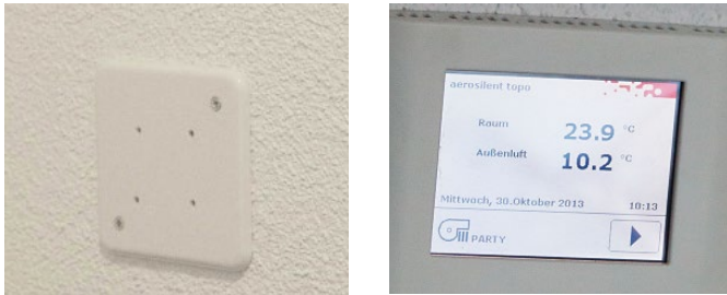
Bild 2. Abdeckung eines Temperaturfühlers (links) und Anzeige der gemessenen Temperatur am Temperaturfühler und der lokalen Außenlufttemperatur (rechts) (Quelle: IEBau) Fig. 2. Cover of indoor temperature sensor (left) and display with indoor sensor and local ambient air temperature (© IEBau)
