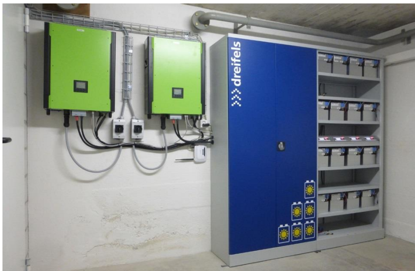
Abbildung 13: Batteriespeicher im UG des Kohlesilos, Quelle: Dreifels, Gelterkinden
