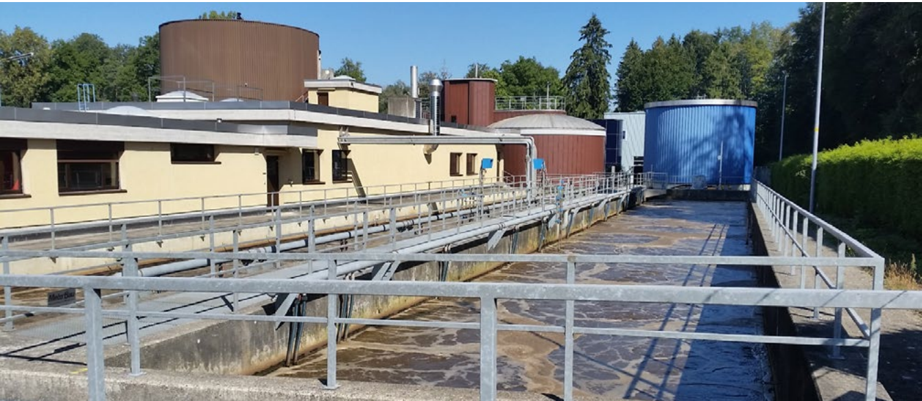
Abbildung 1: ARA Zwillikon mit Klärstrasse, Faulturm (hinten links) und Gasometer (Mitte).
