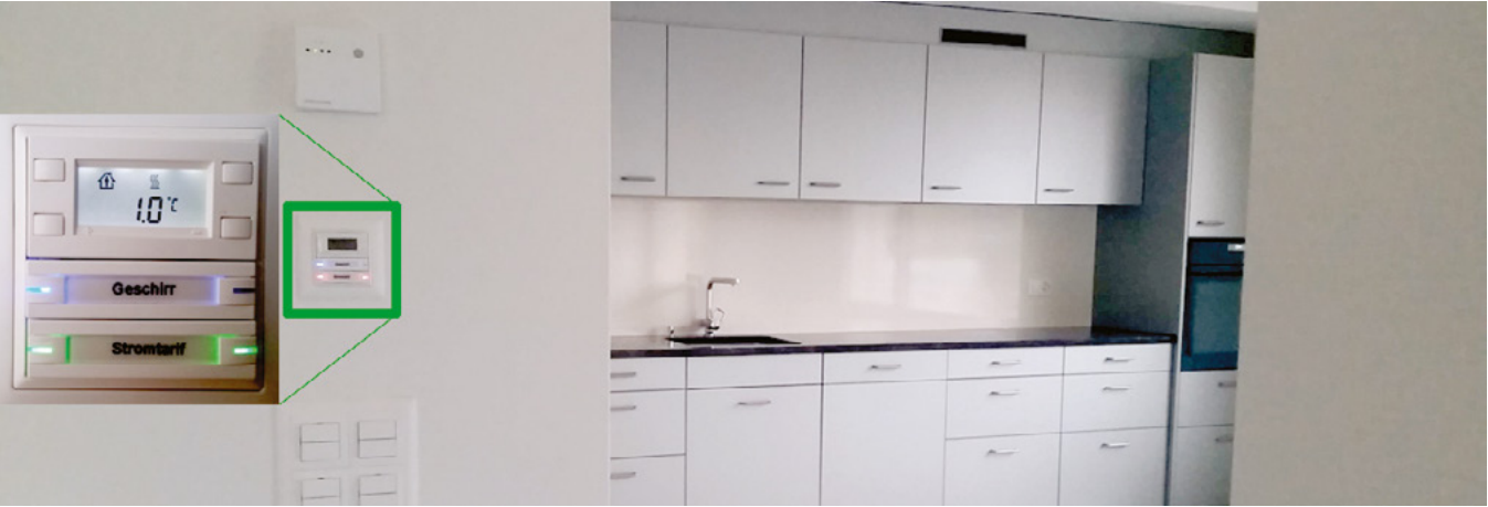
Abbildung 2: Ausrüstung der Wohnungen mit KNX-Raumbediengeräten
