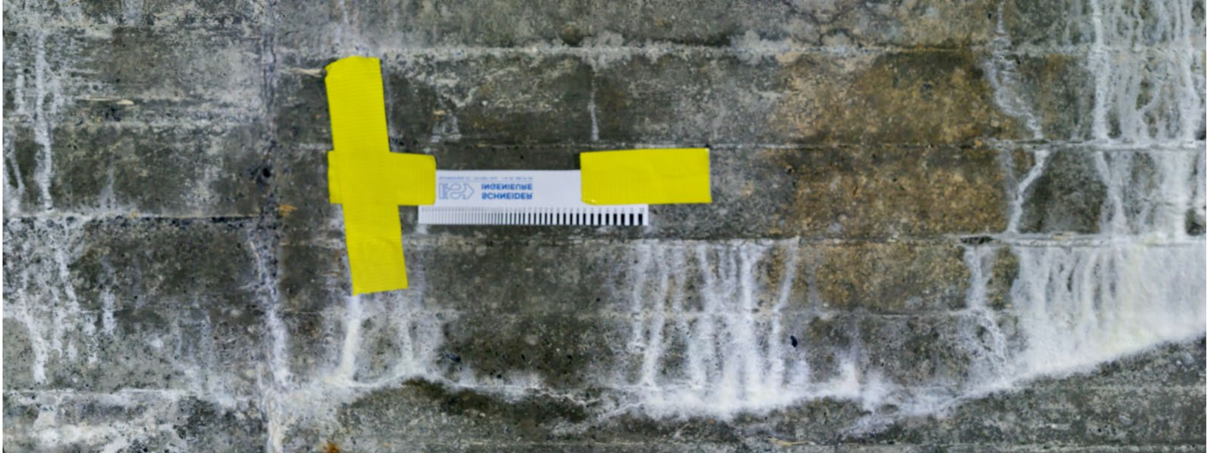
Abbildung: Rissmassstab Orthomosaik Kontrollgang Punt dal Gall (Snapshot AutoCAD)
